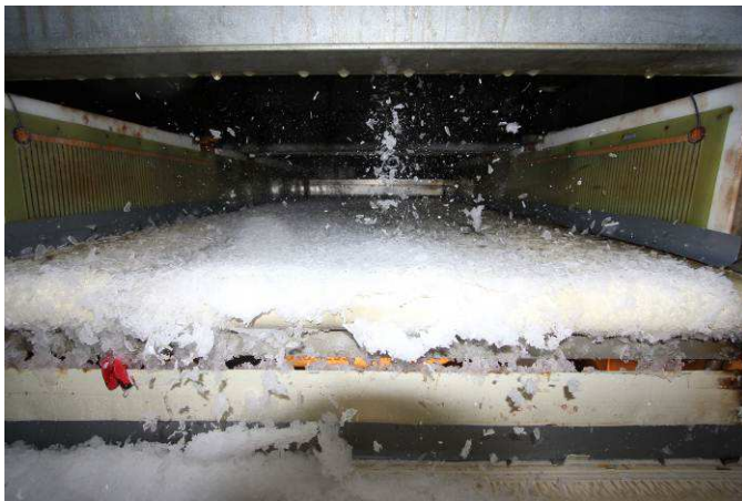
人工造雪機の内部の様子
